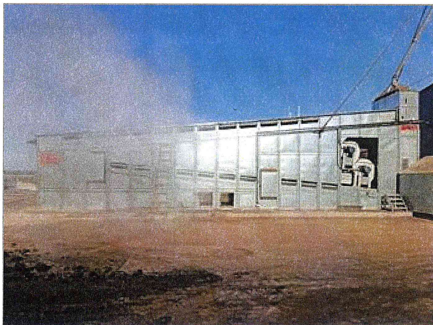
Рисунок 2 – Зерносушилка конвейерного типа Motum-50 в работе в составе технологической линии.
